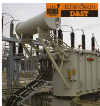
Krafttransformatorer upp till 100 MVA och 170 kV.
